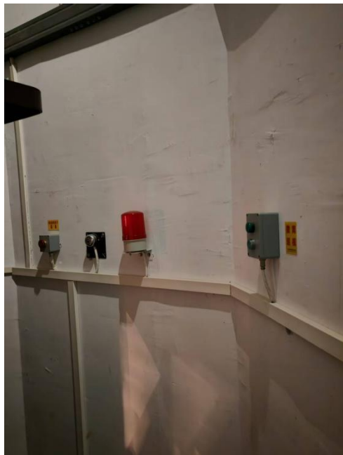
急停按钮、警示灯、巡视撤离、拉线开关
